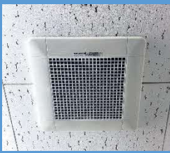
天井設置の換気扇
