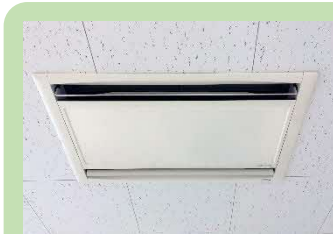
天井設置の熱交換換気
